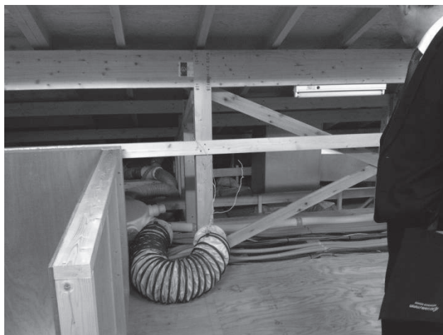
▲空調配管実習設備
