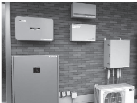
▲パワーコンディショナーと蓄電システム
