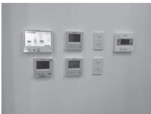
▲電力状況確認用パネル
