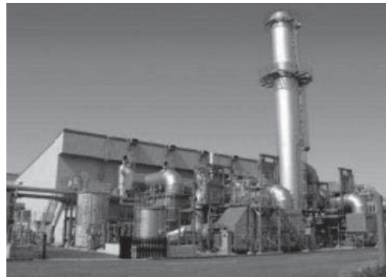
▲コジェネレーション発電施設
